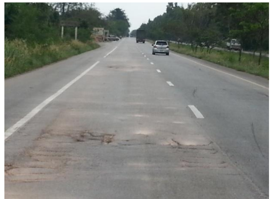
ง. รอยแตกเป็น Block Cracks
